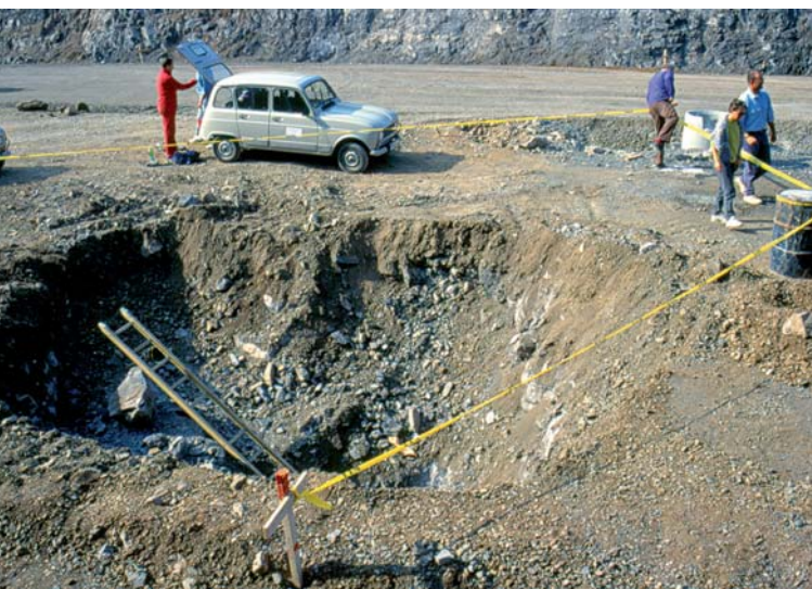
12 Udor na cestišču. The collapse in the roadway.
