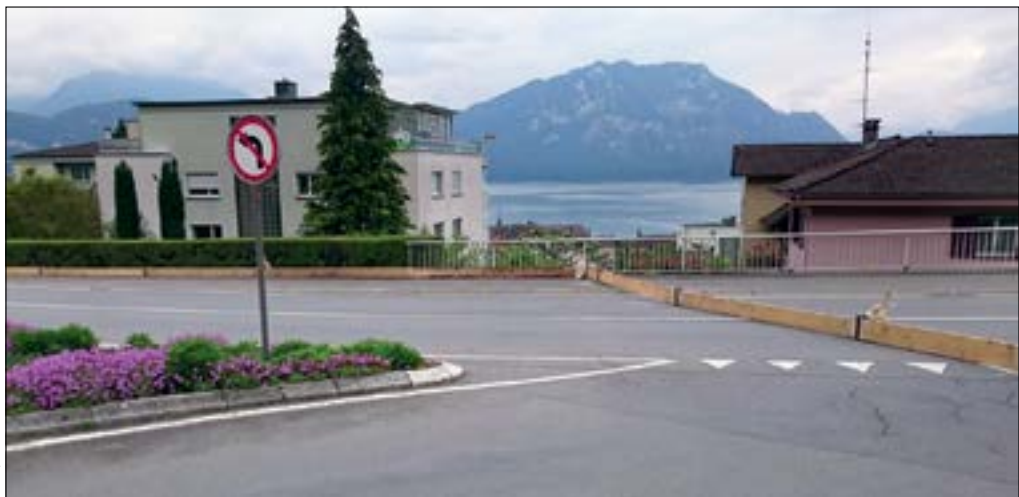
Slika 3: Izvedba ukrepa na terenu (preusmeritev poplavne vode na cestišču stran od stanovanjskih objektov) v kraju Weggis v kantonu Luzern (Švica) v okviru vaje in v skladu z navodili s slike 2.
