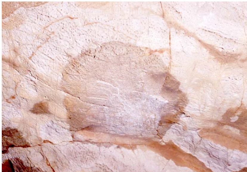
Slika 5.3.18. Vlažen del preperelega stropa je sivo obarvan; iz precejajoče vode se izločajo drobne bele cevčice in tanka plast bele sige.
