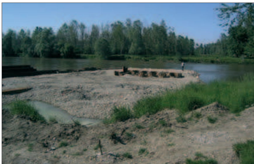
Gradbena dela za "Most prijateljstva" čez reko Muro pri Hotizi. Foto Primož Pipan.
