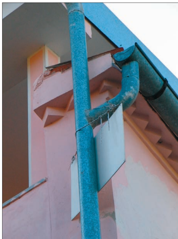
Sl. 2.11.20: Karakterističen detajl je edini ostanek, ki dokazuje kakovost iz preteklosti stavbe (v stavbni dediščini).
