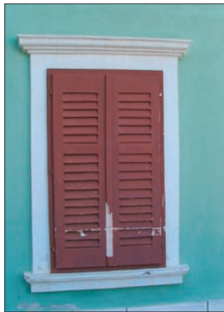
Sl. 2.11.4: Odpadajoča štukatura izdaja slepo okno.
