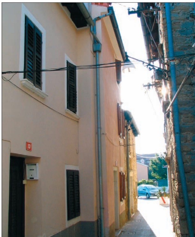
Sl. 2.11.9: Pozidava dveh oken nad vrati zmanjša vrednost stavbe in del mestne vrednosti.
