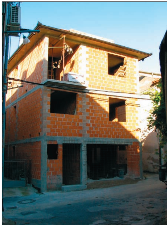
Sl. 2.11.22: Novogradnja v starem jedru Koprja, ki ne upošteva zgodovinskih značilnosti mesta.
