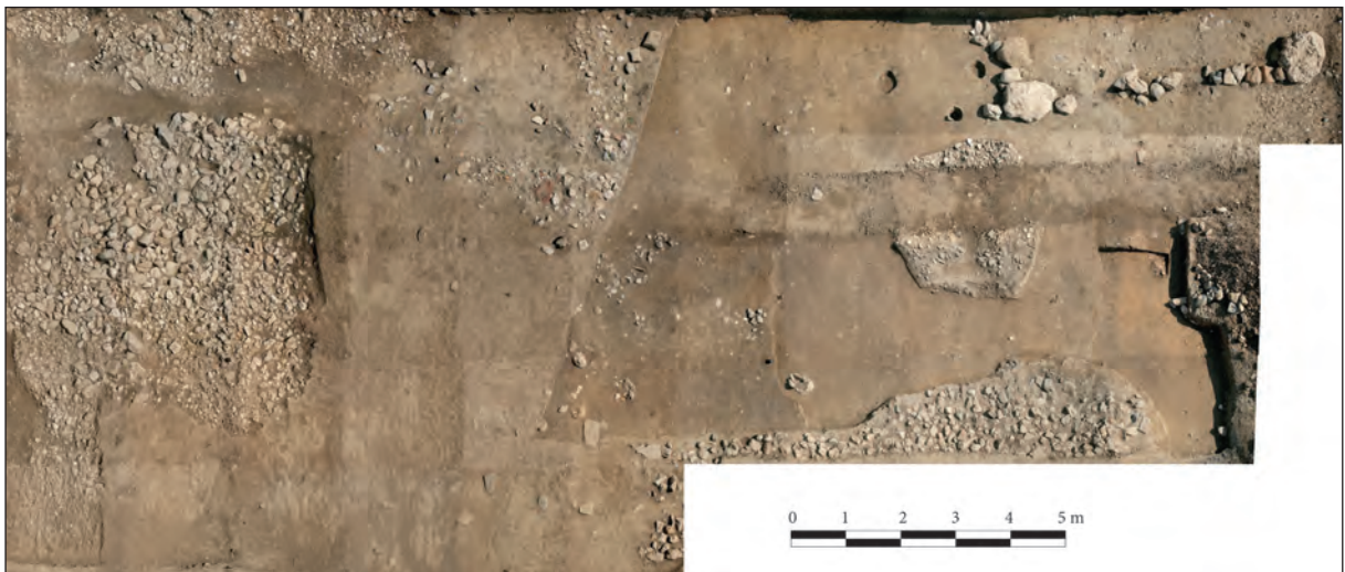
Sl. 18: Stari trg pri Slovenj Gradcu, rimsko grobišče in poznorimska naselbina. Raziskave v letih 2006–2007. Stavba in jugozahodno od nje plato zgodnjerske grobnice (lokacija na sl. 11: zelena pika ob VIII/06).
