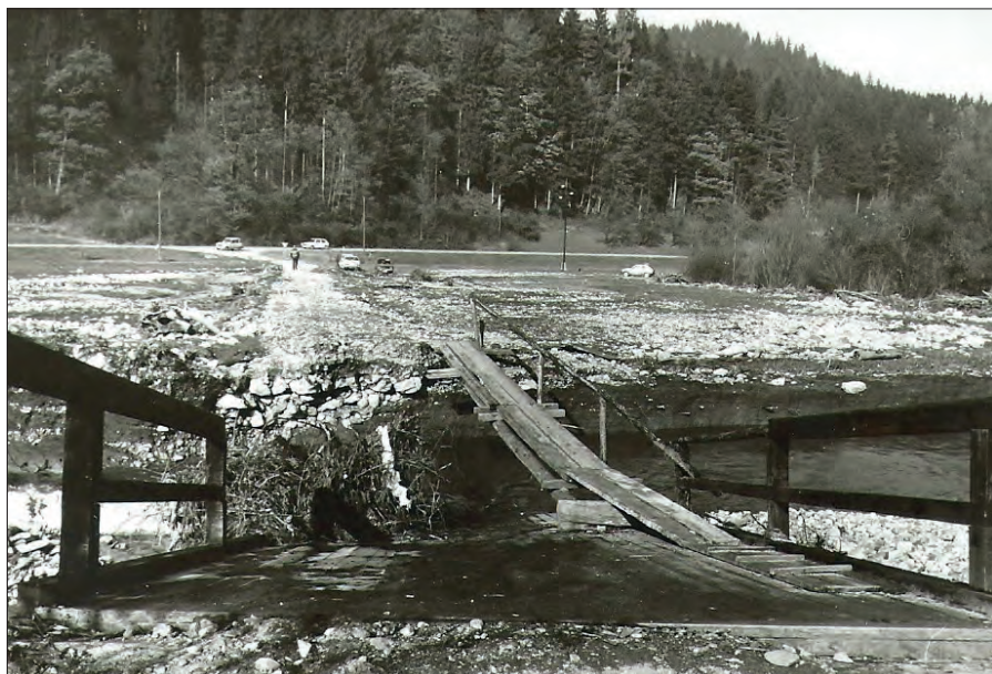
Porušen Rogačnikov most v Dolu nad Gornjim Gradom med novembrsko poplavo leta 1990. Foto: Drago Kladnik.
