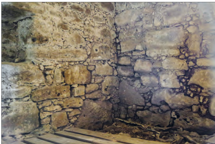
14. Struktura kamnite zidave iz sredine 16. stoletja v kleti dvora (© foto: Igor Sapač)
