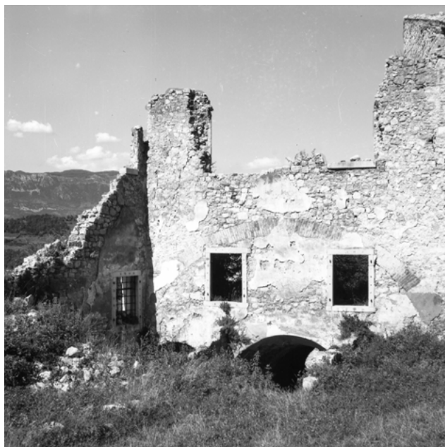
Slika 3: Delno porušena dvoriščna fasada veznega trakta z opečnim lokom (© ZVKDS OE Nova Gorica)
