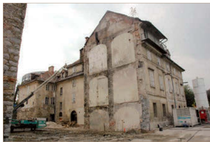
Pogled na porušen srednji del Cukrarne
