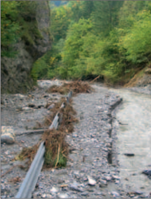
Slika 50: Poplava 18. septembra 2007 je v ozki dolini Davče uničila cesto, obnovljeno po prav tako uničujoči ujmi leta 1995.
