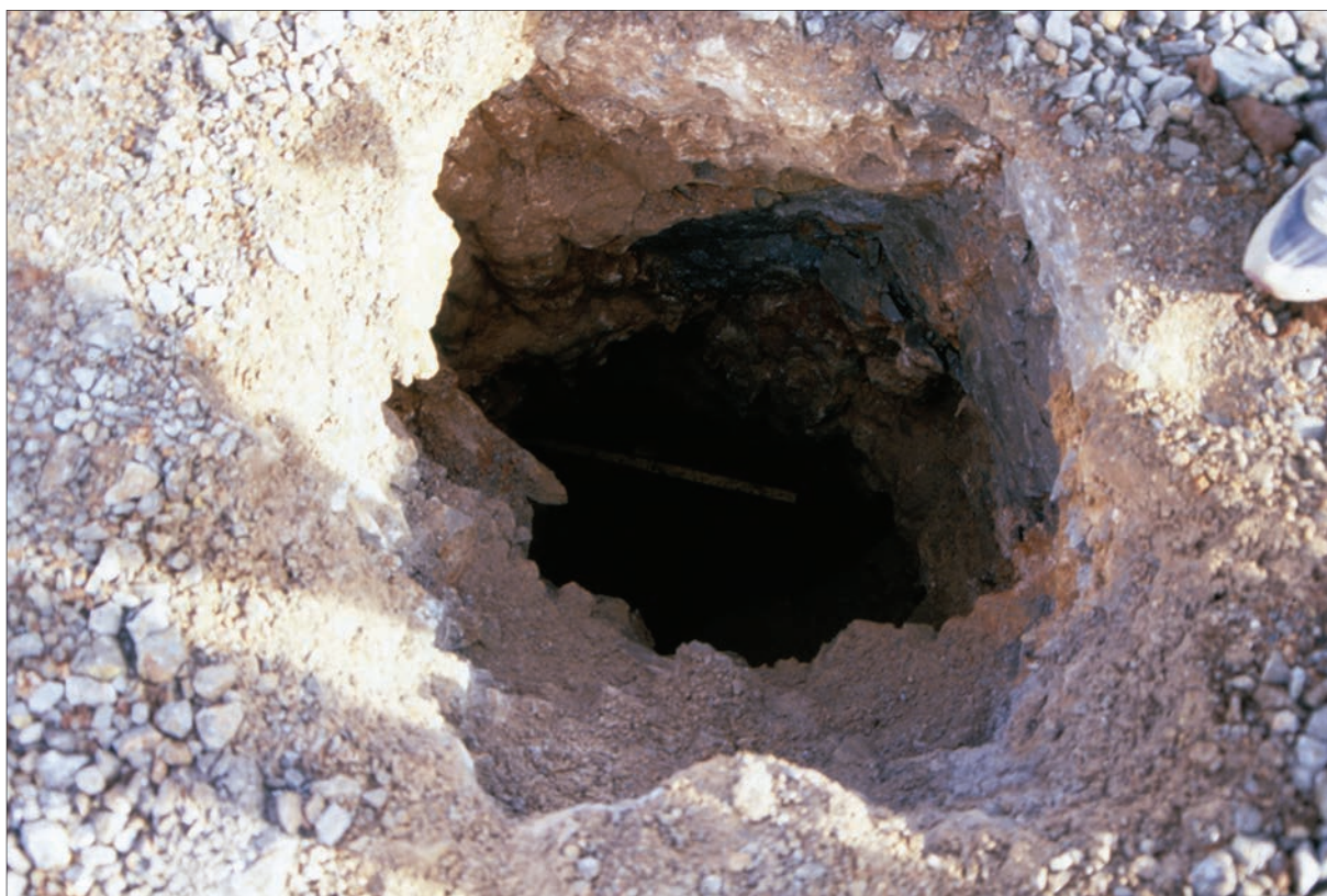
Slika 4.5: Udor stropa stare jame.
