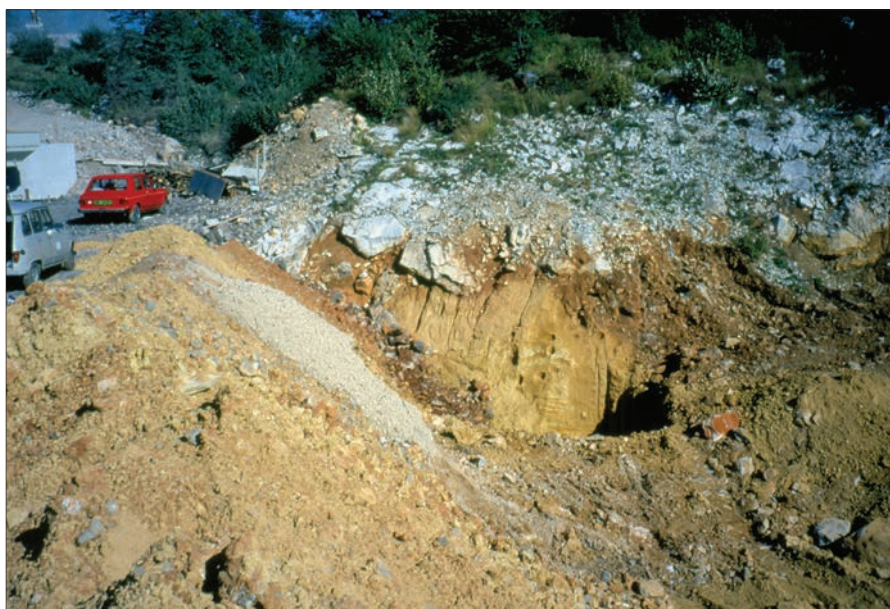
Slika 17.1: Zapolnjena jama južno od Divače v vrtači na vzhodnem robu gradbišča avtoceste Divača–Kozina.
