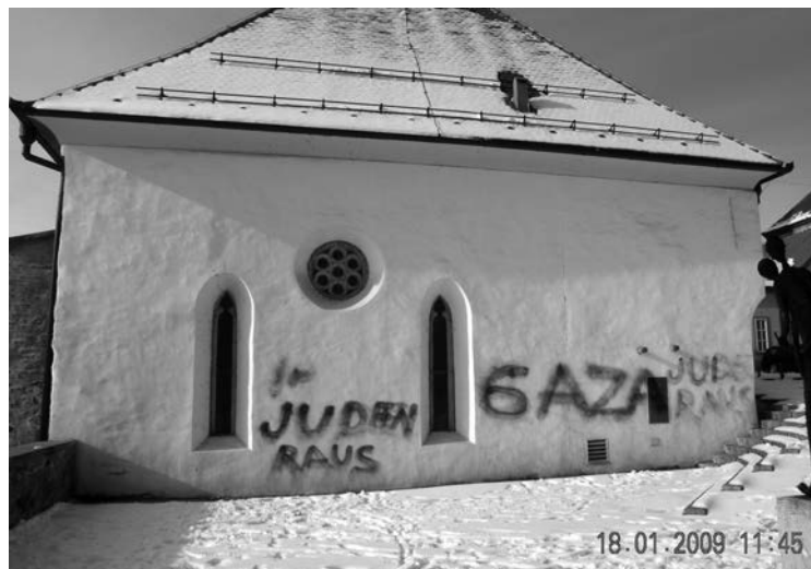
Slika 17: Sovražni napisi na pročelju zgradbe mari-borske sinagoge iz januarja 2009 (Arhiv Sinagoge Maribor).
