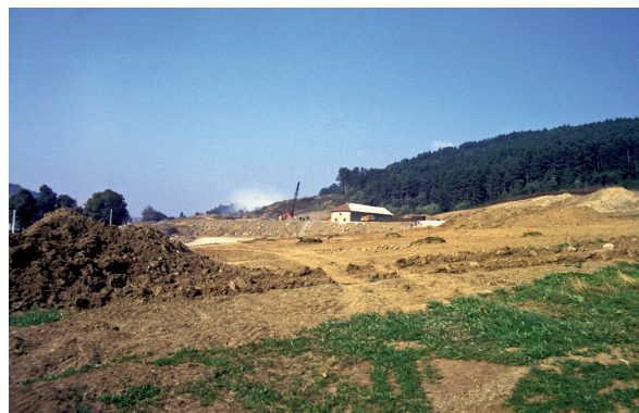
Sl. 28: Mandrga. Površina, ki jo je poškodoval strojni odziv zemlje. Pogled proti zahodu. Foto: V. Schein.
