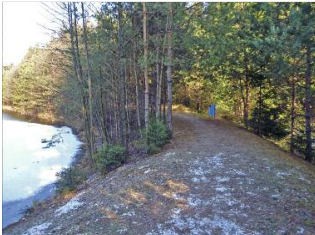
Slika 5: Primer slabe in nevarne prakse: gosto zaraščene brežine pregrade.
